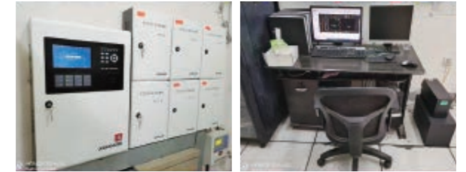
可燃性ガス警告システム
