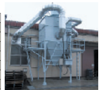
集塵機付き排気装置
