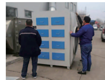
増設したVOC処理装置の活性炭箱
