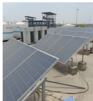
設置した太陽光パネル
