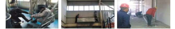
高速分散機のメンテナンス アラームシステムの点検 防爆壁の工事
