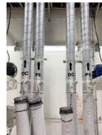
用途別排気ダクト
