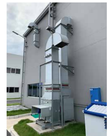
排気処理装置
