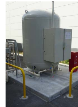
LPガスタンク
