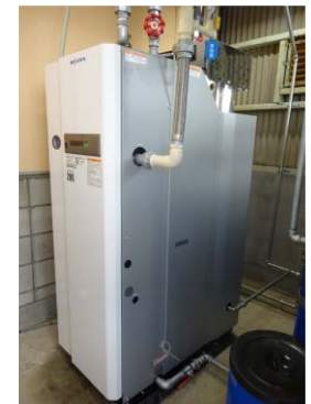
簡易貫流蒸気ボイラー
