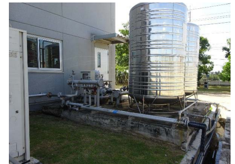
フジクラカセイタイランド上水タンク
