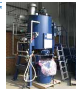
新規に導入した溶剤蒸留装置
