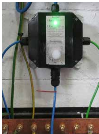
チェスターフィールド工場のアース自動確認システム Automatic earth detection system at FCS Chesterfield.
