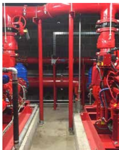
新しいポンプ New Sprinkler water pumps at Chesterfield.
