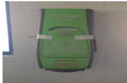
洗顔ステーションのカバー Enclosed eyewash stations.
