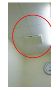
A ventilation fan
